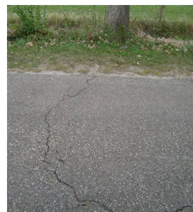
Verhardingsopdruk door boomwortels
