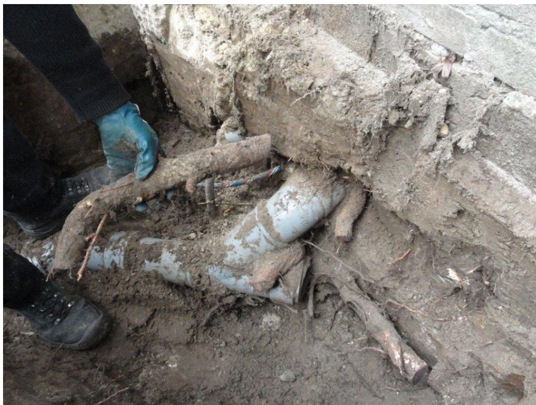
Schade aan de riolering door ingegroeide boomwortels
